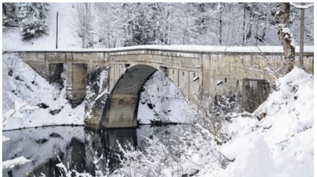
Erhalten oder abbrechen? Bei der Schrähbachbrücke in Innerthal scheiden sich die Geister.
